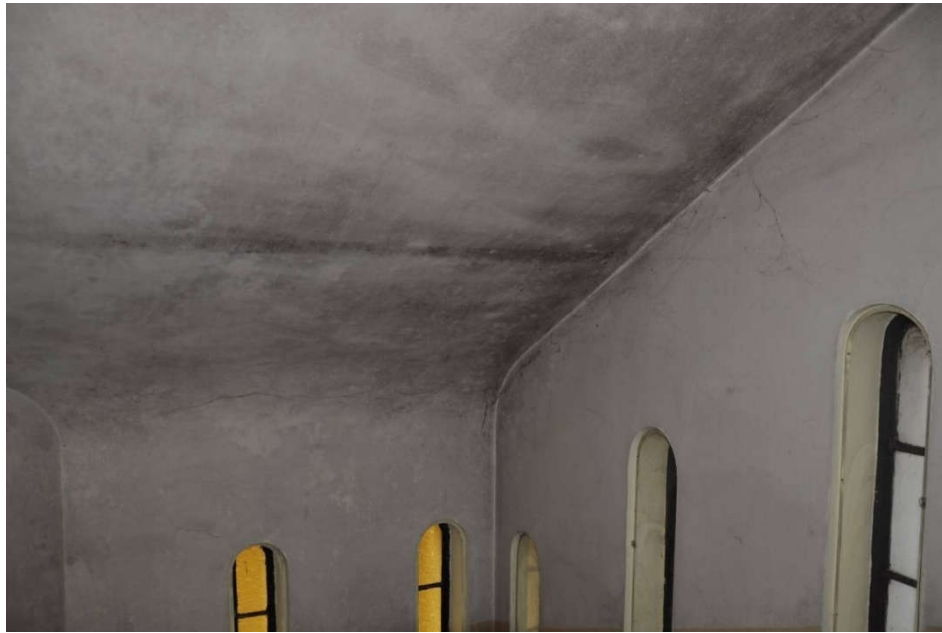
Widok na zapleśniały tynk stropu i ścian klatki schodowej
