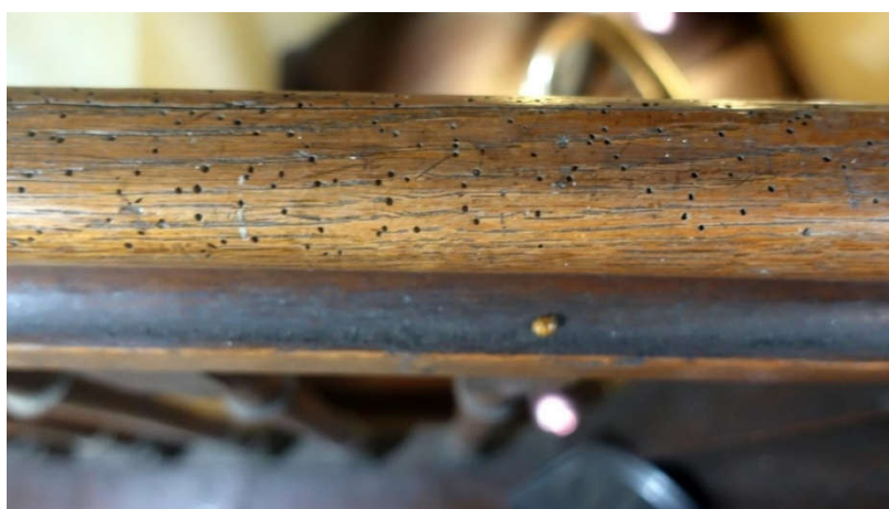
Przykład mocno uszkodzonej balustrady
