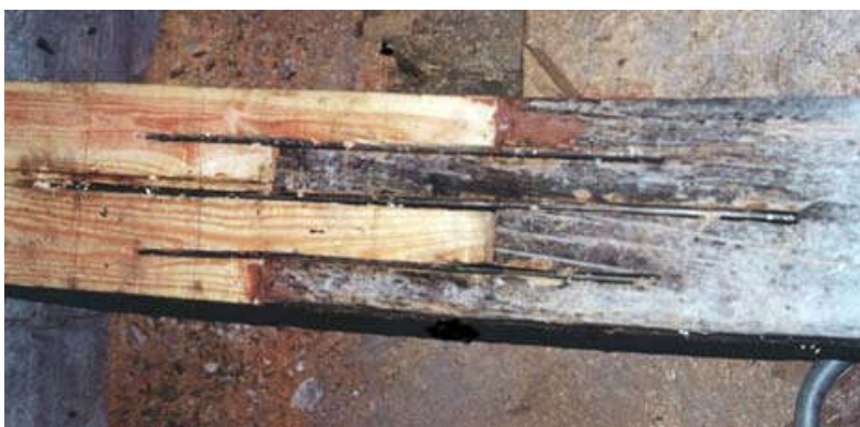
Połączenie belek na zwidłowanie wzmocnione pionowymi blachami stalowymi przygotowane do zalania żywicą epoksydową
